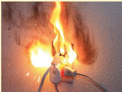
トラッキングによる出火事例
